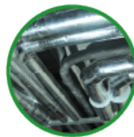
Calorifugeage des réseaux d'eau chaude
